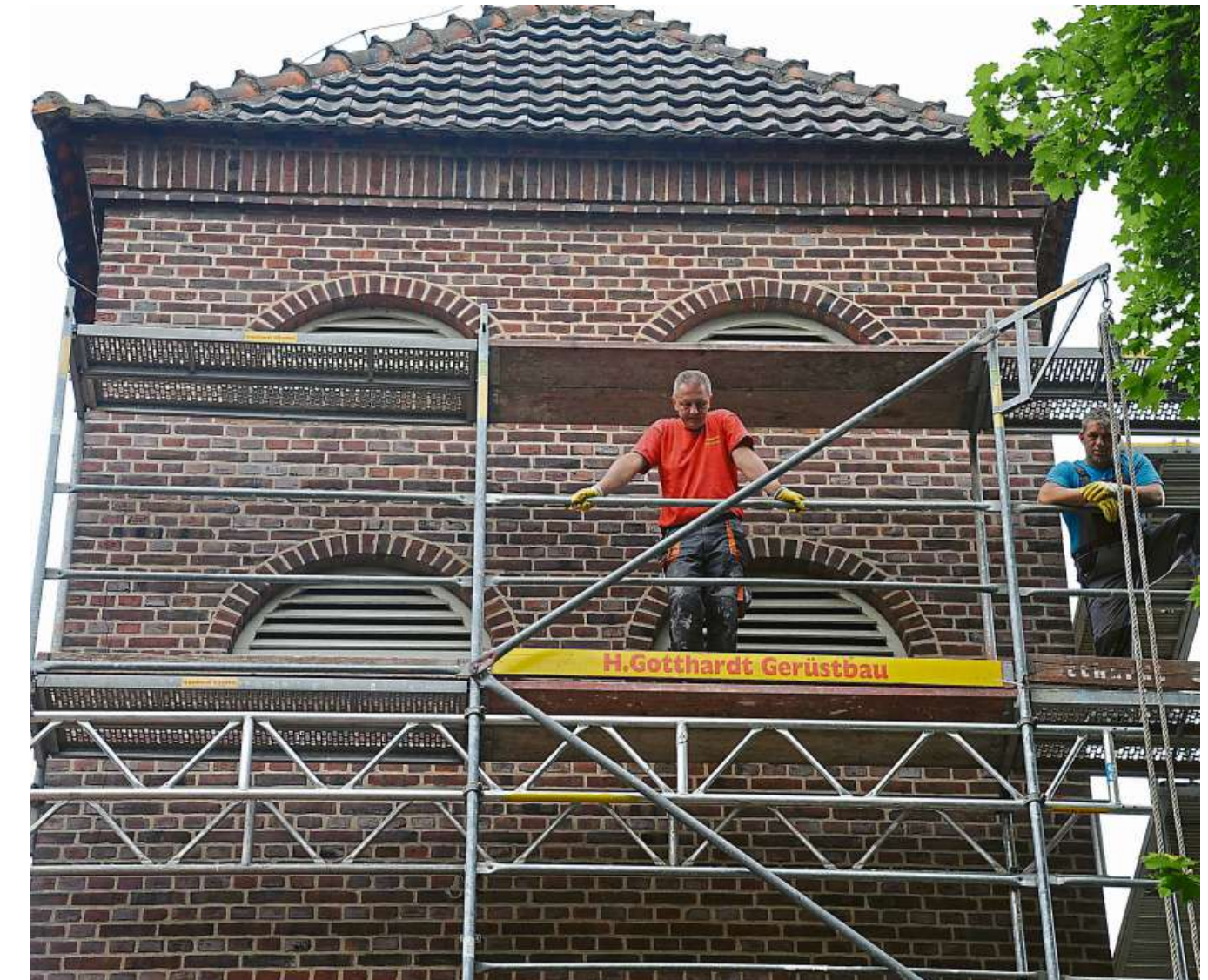
Vor zwei Jahren war der Turm des Museums schon einmal komplett eingerüstet. Jetzt durchziehen erneut Risse das Mauerwerk. Museumsleiter Muschinski betont: „Die Stadt lässt das Gebäude nicht verkommen wie einst den Bahnhof.“ Foto: gro
